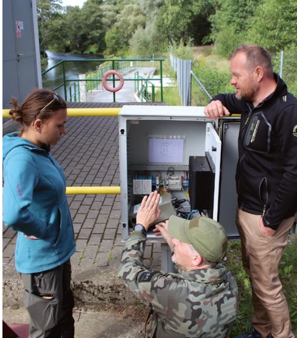
Monitoring system at a fish ladder at HPP Rościno Monitoringsystem an der Fischtreppe des WKW Rościno
